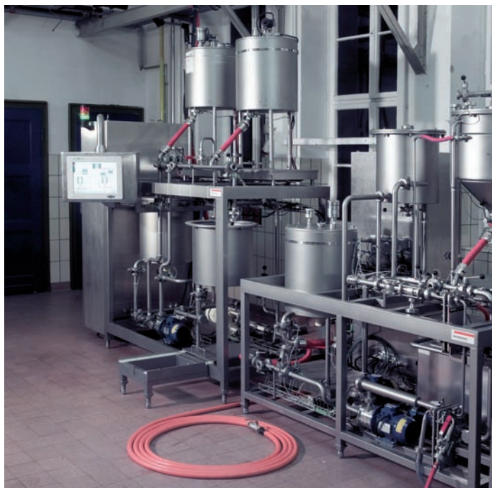
Die neue Lehr- und Versuchsbrauerei am Campus Geisenheim setzt Maßstäbe in Puncto Steuerung (Foto: Lönarz)
